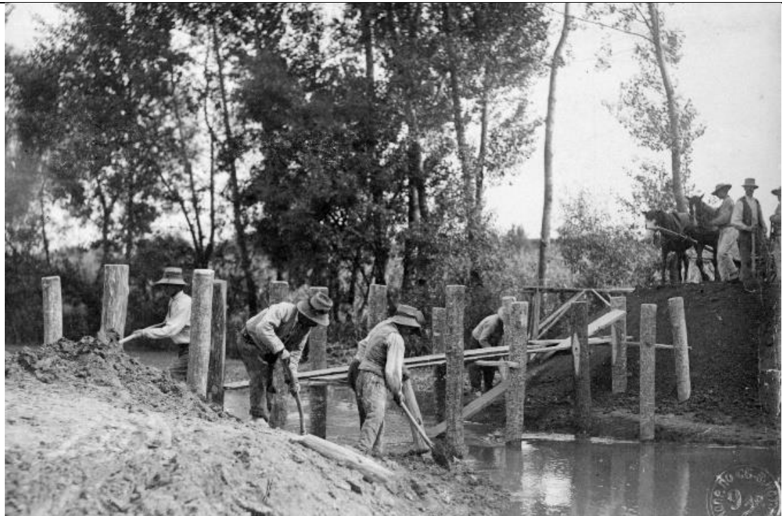
РГАКФД. Альбом 92. Фотографические снимки из боевой и походной жизни Штаба и частей войск, входящих в состав IX Армии 1914–1916 гг. Снимок 6. Сооружение плотины на реке Липе. Работа по забивке и засыпке землей свай. Б/м, 1915 г.
