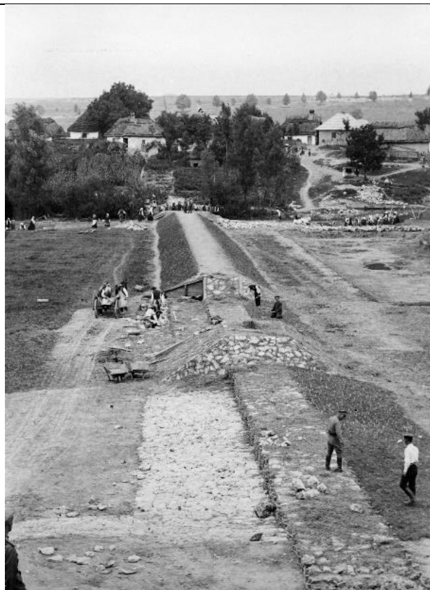
РГАКФД. Альбом 92. Фотографические снимки из боевой и походной жизни Штаба и частей войск. Входящих в состав IX Армии 1914–1916 гг. Снимок 76. Сооружение плотины на реке Гниле. Работы по сооружению, общий вид. Б/м, 1915 г.
