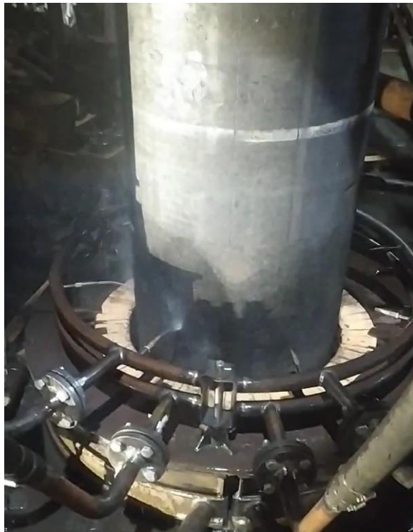
Рисунок 4.7 – Фотография смонтированной на первой фазе системы ИО
