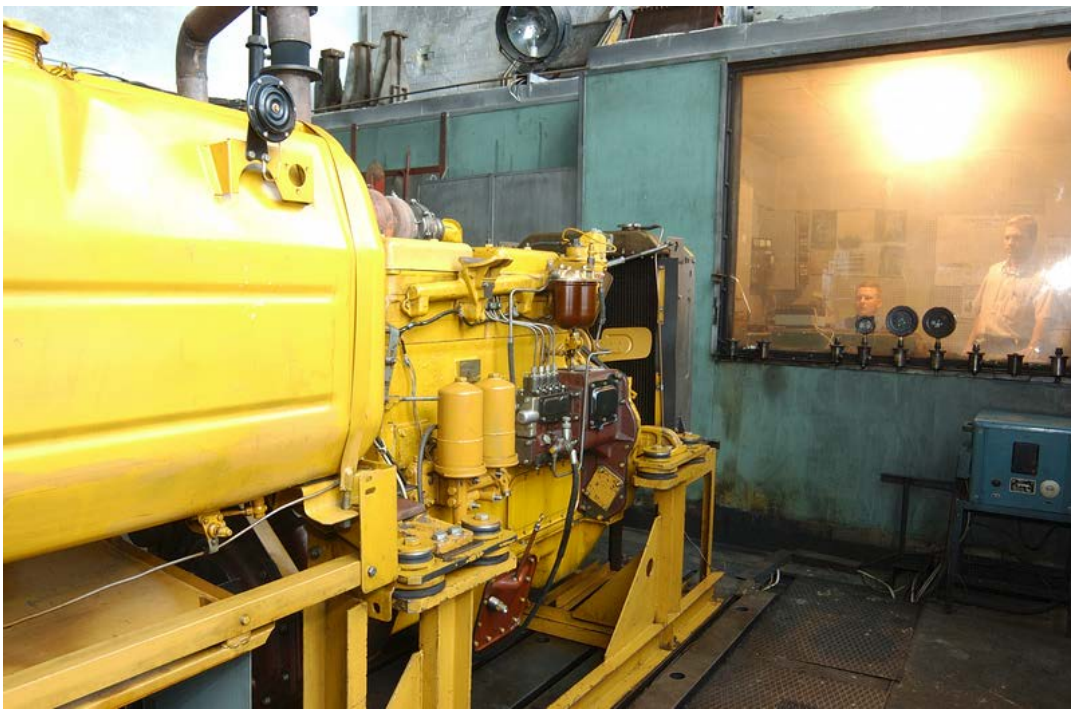
Рисунок 3.1 – Энергоустановка ДГУ-100С на стенде ОАО «НИИ АТТ»
