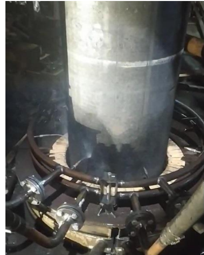
Рисунок 11 – Фотография смонтированной на первой фазе системы ИО
